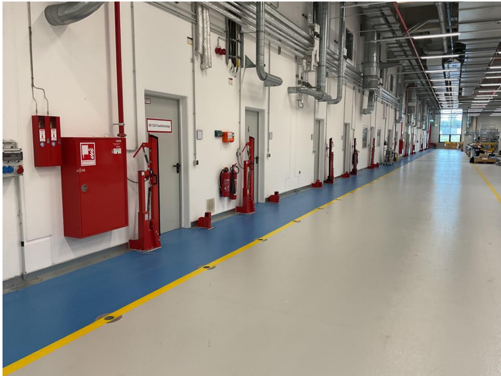
Abb. 9-10: Halbautomatische Löschwasserbarrieren mit Taster vor Ort und Zentraltaster
